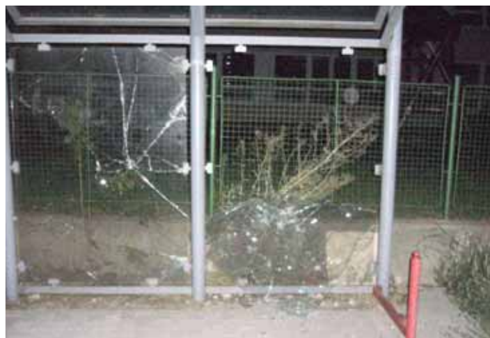
Rozbitá sklenená výplň autobusovej zastávky pred školou
